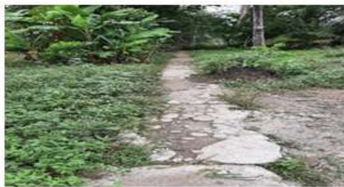
Gambar 3. Kondisi lokasi infrastruktur jalan setapak RT 02 RW 02
